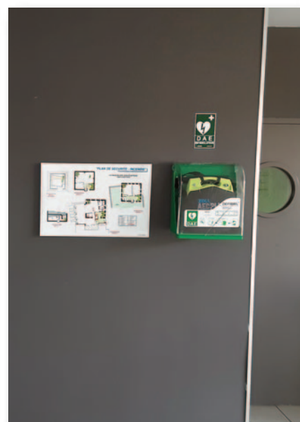
Défiibrillateur installé à la Maison des Associations
