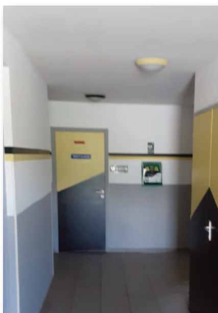
Défiibrillateur installé au vestiaire du foot
