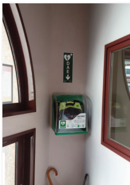
Défiibrillateur installé à la Mairie
